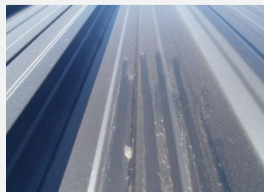
Figur 7: Støv som la seg på hos taket til RF etter velt nevnt overfor.
