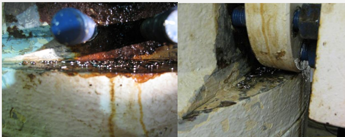
Figur 9: Bilde fra en ventil som blir skrudd fra hverandre på Ekofisk
