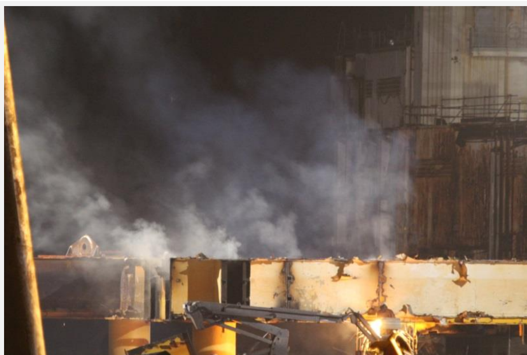
Figur 4: Eksempel på støvflukt pga. skjærebrenning.
